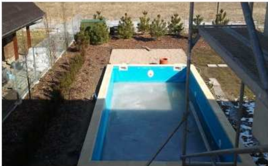
(O instalacjach warto pomyśleć na etapie budowy basenu)
